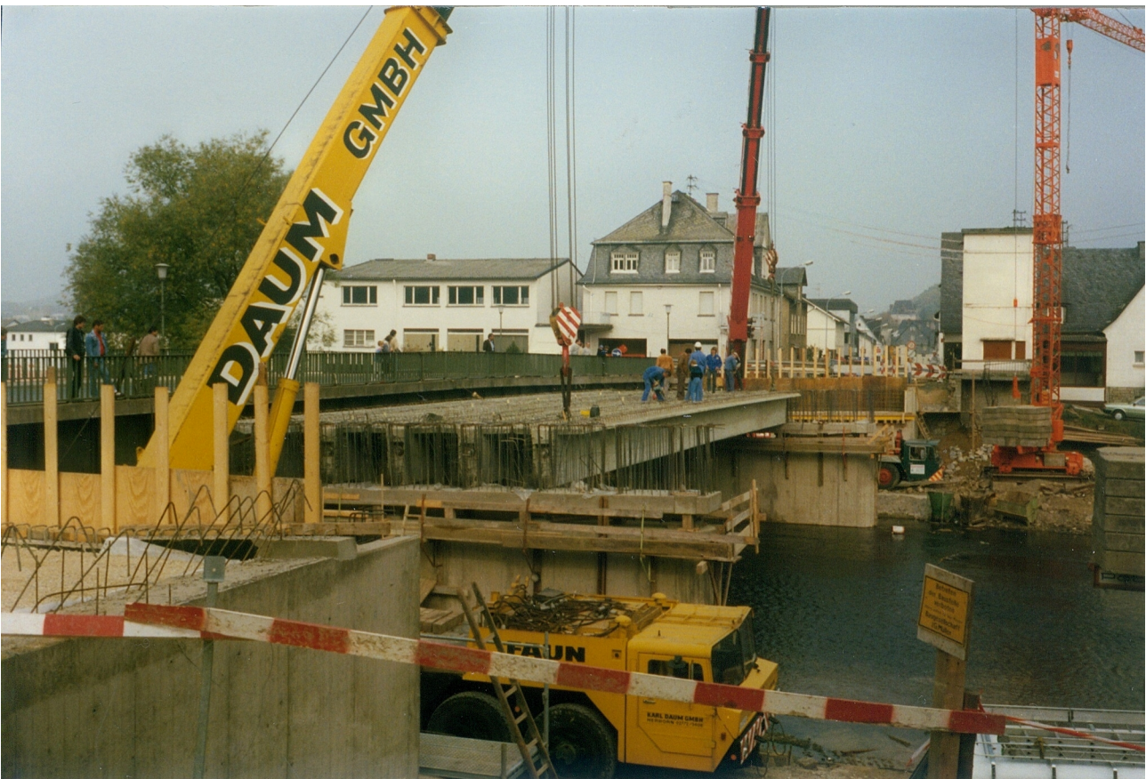
Die vorgefertigten Stahlbetonträger werden auf die neuen Pfeiler aufgelegt. Zuschauer beobachten diese Arbeiten von der alten Stahlbrücke aus.
