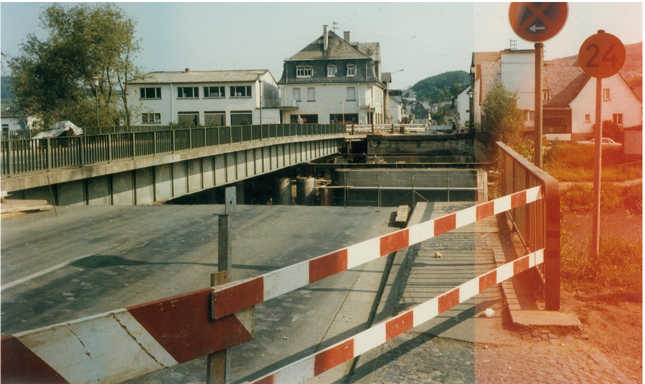
Verschiebung erledigt. Die Pfeiler der alten Brücke stehen noch, der Neubau kann mit deren Abriss beginnen. Die alte Brücke dient nun für die Bauzeit als Umleitung.
